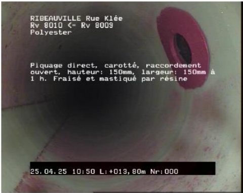
1Rv 8010Rv 8009-2.jpg, 00:00:45, 13.80m Piquage direct, carotté, raccordement ouvert, hauteur: 150mm, largeur: 150mm à 1 h. / Fraisé et mastiqué par résine
