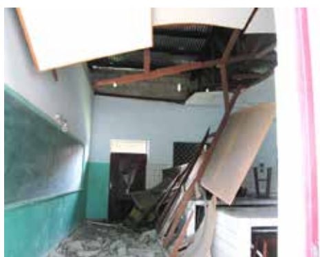
Février 2012, le collège gravement endommagé
