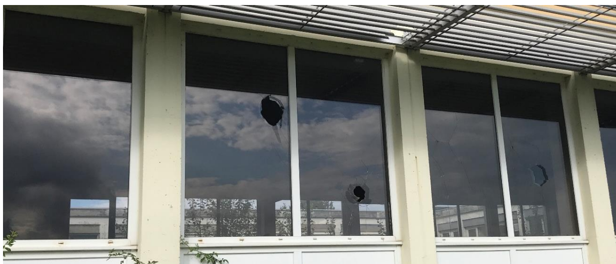
Figure 10 : Quelques fenêtres partiellement brisées
