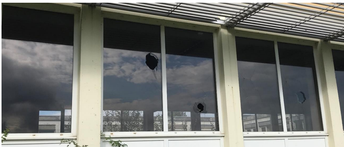
Figure 10 : Quelques fenêtres partiellement brisées
